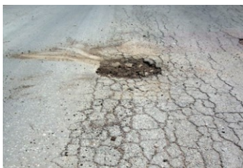
Gambar 1. Perbedaan Kerusakan Pothole dengan Kerusakan Perkerasan Lainnya dan Contoh Kerusakan Pothole (Sumber: Pothole Repair Manual, National Cold Asphalt )
